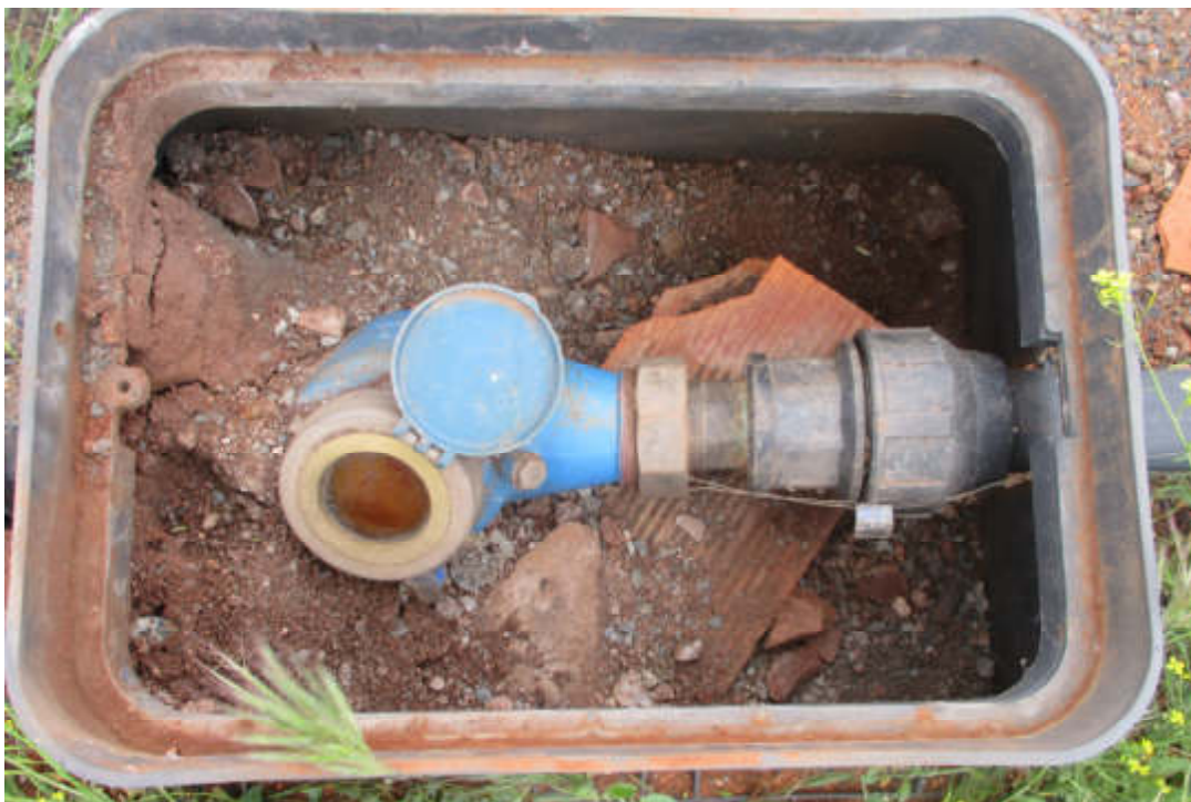
Figura 7.4. Contador en mal estado. Esfera ilegible.
